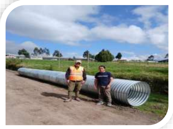
Fiscalización en la Comunidad de Cajas
