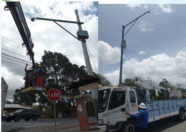
Ilustración 3: mantenimientos cámaras ECU 911
