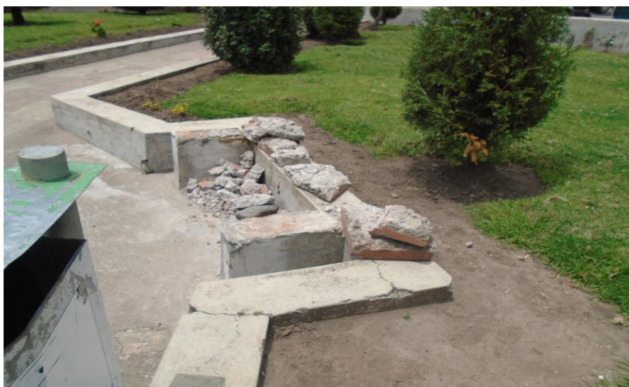
FOTO N° 8: Escombros en el interior del parque, bordillos por pintar en el parque de Tupigachi y en el cementerio de Tupigachi.
