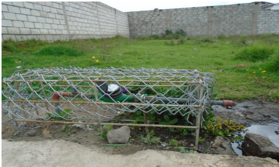
FOTO N° 6: Poca seguridad en los medidores de agua en Centro de Convenciones Tabacundo.
