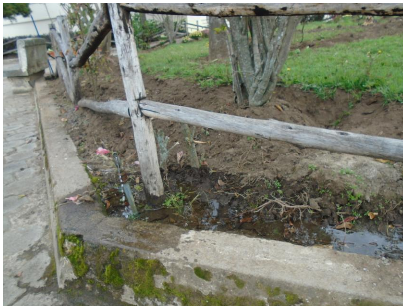
FOTO N° 3: grifos dañados en el parque Tocachi.
